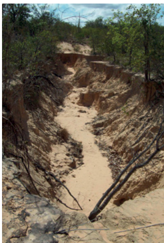
Foto 23 Erosão a nível de voçoroca atinge estrada de chão e a interdita, em Correntina-BA
